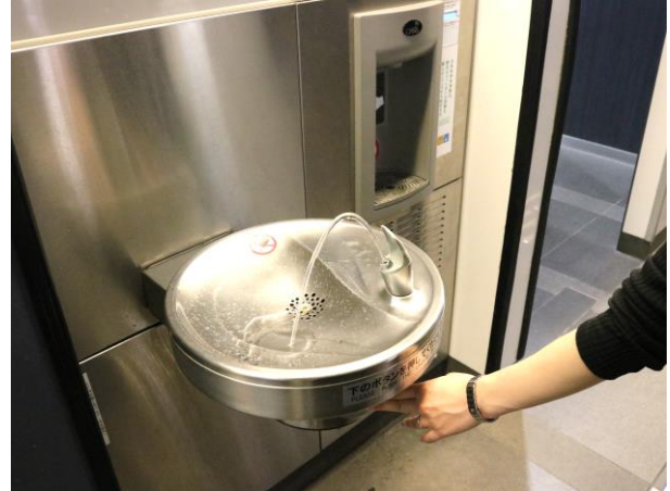
かい かい きゅうすいき 1階・7階 給水機
